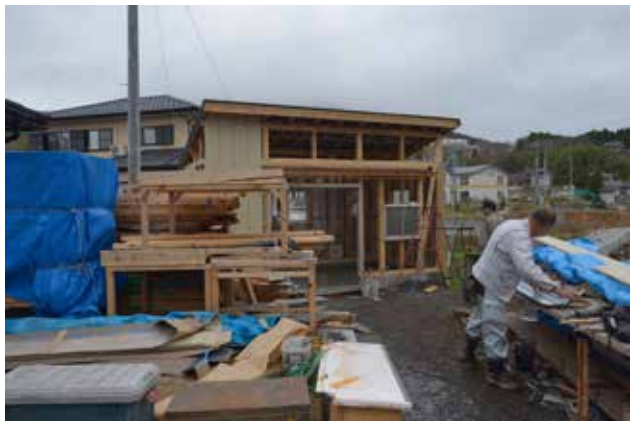
(写真 7-9) 「居場所ハウス」屋外の食堂は寄付された木材も活用して建築
